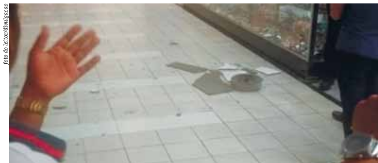
Pedaco do forro do teto caiu no estabelecimento e quase feriu frequentadores do local
