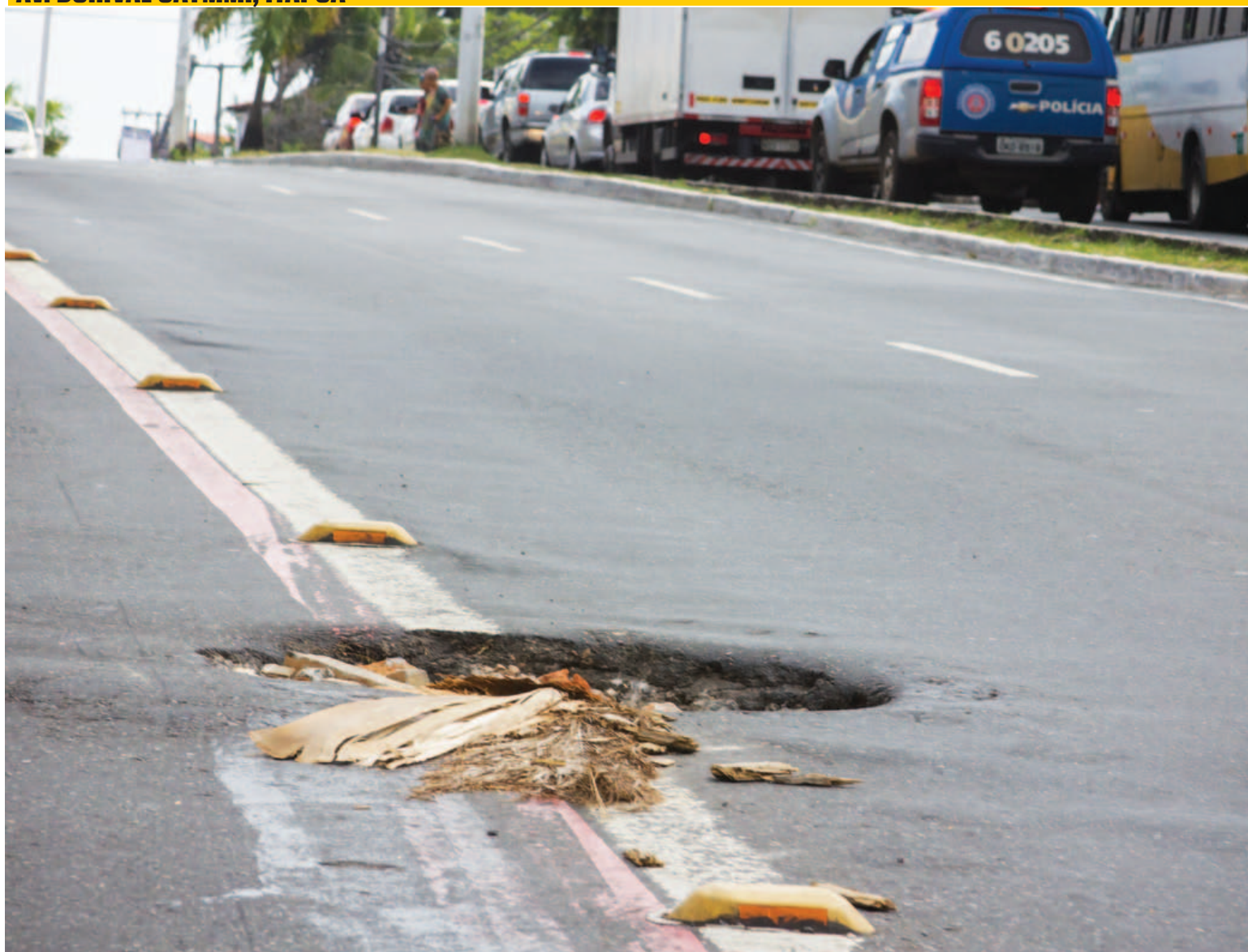
Em Itapua, lá estão os bueiros abaixo do nível da via. Apesar de o asfalto estar bem alinhado na região, a própria Prefeitura deixa que sejam criados estes buracos
