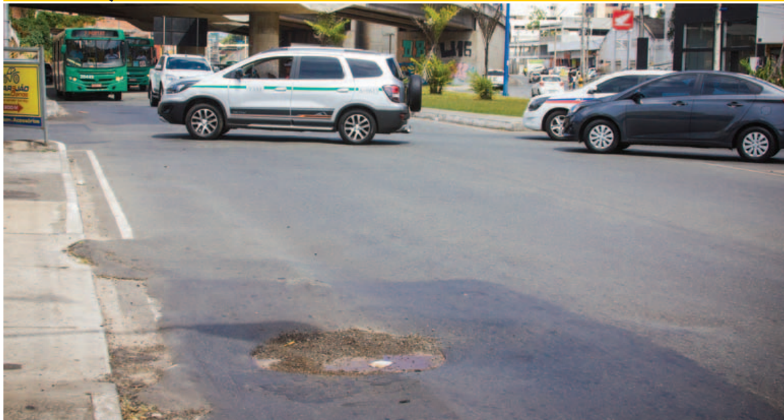
Na Baixa de Quintas, a região da via pela qual passam os ônibus já está maltratada, e tudo piora por causa dos buracos criados pelos bueiros
